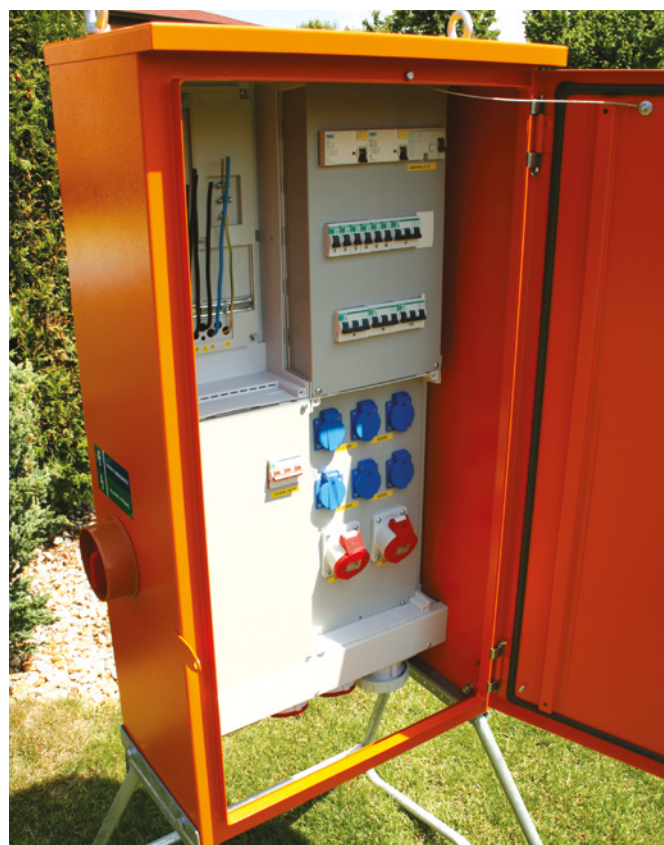
Provedení v souladu s normou ČSN EN 61439-4 ed.2, přehledné a logické uspořádání vnitřních komponentů
