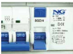
Standardně jistíme a chráníme vlastními přístroji se zkratovou odolností 10 kA.
